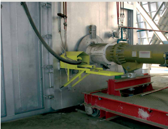
→ Pyroscan instalado cerca del quemador
